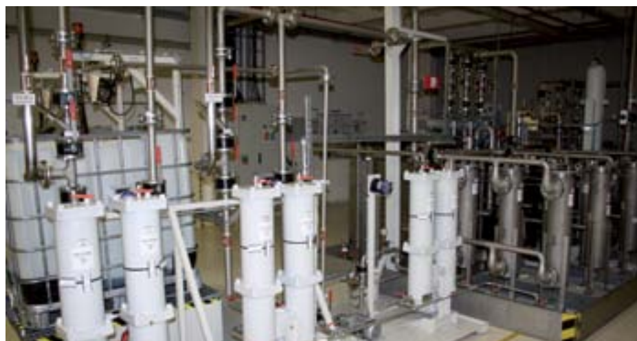
▲ Sada filtračných zariadení hydraulického oleja používaného pri skúšaní funkčnosti mechatroniky
